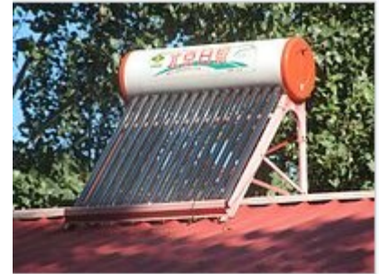
Énergie solaire thermique : Chauffe-eau solaire
